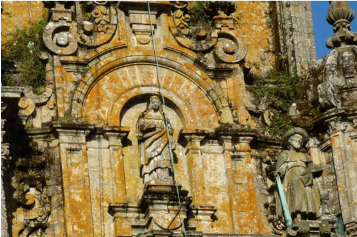
Figura 5. Fachada de la catedral de Santiago, donde se aprecia la colonización por parte de líquenes (fuente: https://www.flickr.com/photos/88068852@N05/10648350934 )
